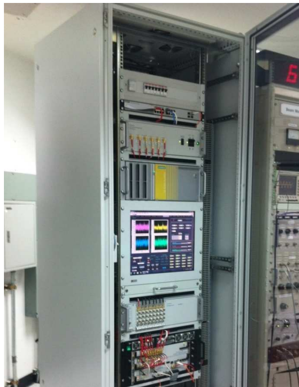
รูปที่ 19 แสดงระบบควบคุมคลื่นวิทยุภาคกำลังต่ำที่ติดตั้งในห้องควบคุม
