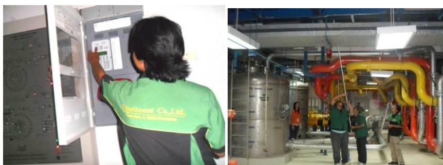
รูปที่ 7 แสดงการตรวจสอบระบบแจ้งเหตุเพลิงไหม้
